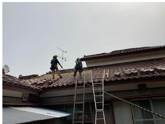
町内の屋根の被害
