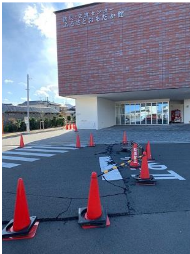
町内の被害状況
